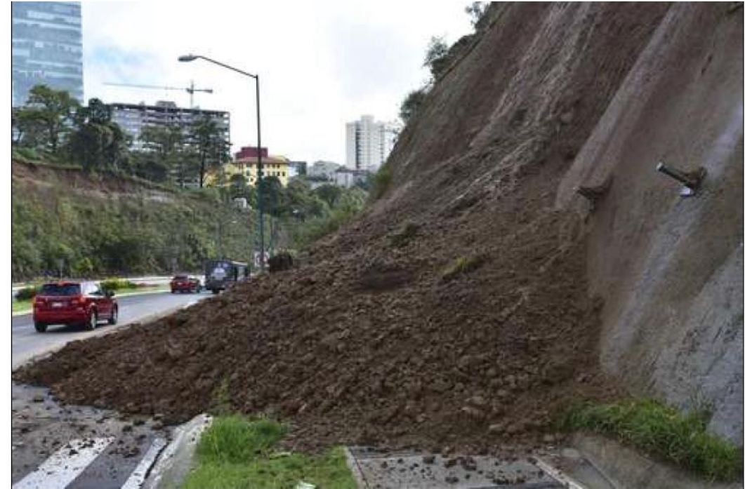
Desde la noche del lunes bomberos de la Ciudad de México trabajan en las labores de limpieza en las inmediaciones del estacionamiento subterráneo de un edificio ubicado en Bosque de Radiatas 10, de la colonia Bosques de las Lomas, en Cuajimalpa, que quedó inundado por la tromba. Foto Cuartoscuro
